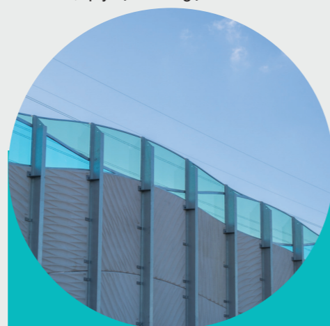
Tiếp tục gắn tường chắn tiếng ồn trên đường cao tốc West Gate Freeway.
