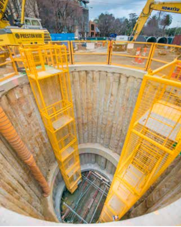
يتم نقل شبكة الصرف الصحي الرئيسية في South Yarra من أجل مشروع نفق المترو.
