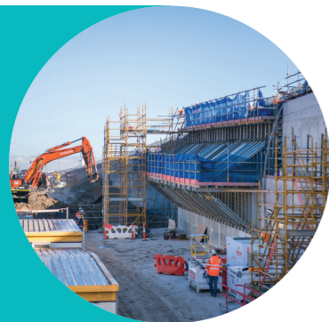
Việc đào đất tại lối ra khỏi đường hầm về phía ngoài thành phố
